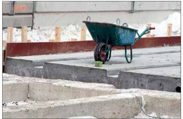
Tvårsnitt av nygjuten betongkropp. Efter gjutning läggs temporärt markduk i rännorna och asfalt fylls på. När spårläggning ska ske, tas fyllningen bort och rännan blåstras. Efter blåstring är rännan klar för spårläggningens alla moment.
