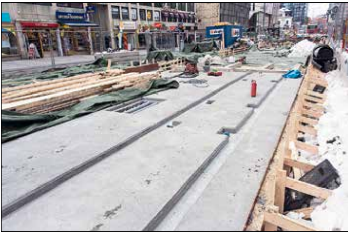
Rännorna i de platsgjutna betongkropparna i spårvägsförlängningen i Stockholms city är omkring nio centimeter djupa och i dem placeras lågprofilräl typ LKI.
