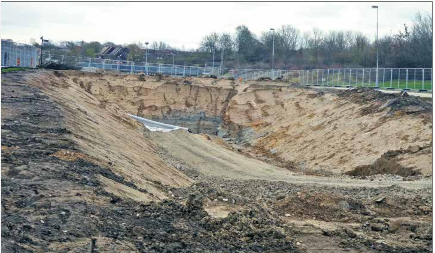
Förberedelser för bygget av den nya bron under E 22 pågår här i april 2017. Bron kommer att byggas vid sidan av motorvägen och sedan lanseras på plats när den är färdig. Foto: Per Gunnar Andersson
