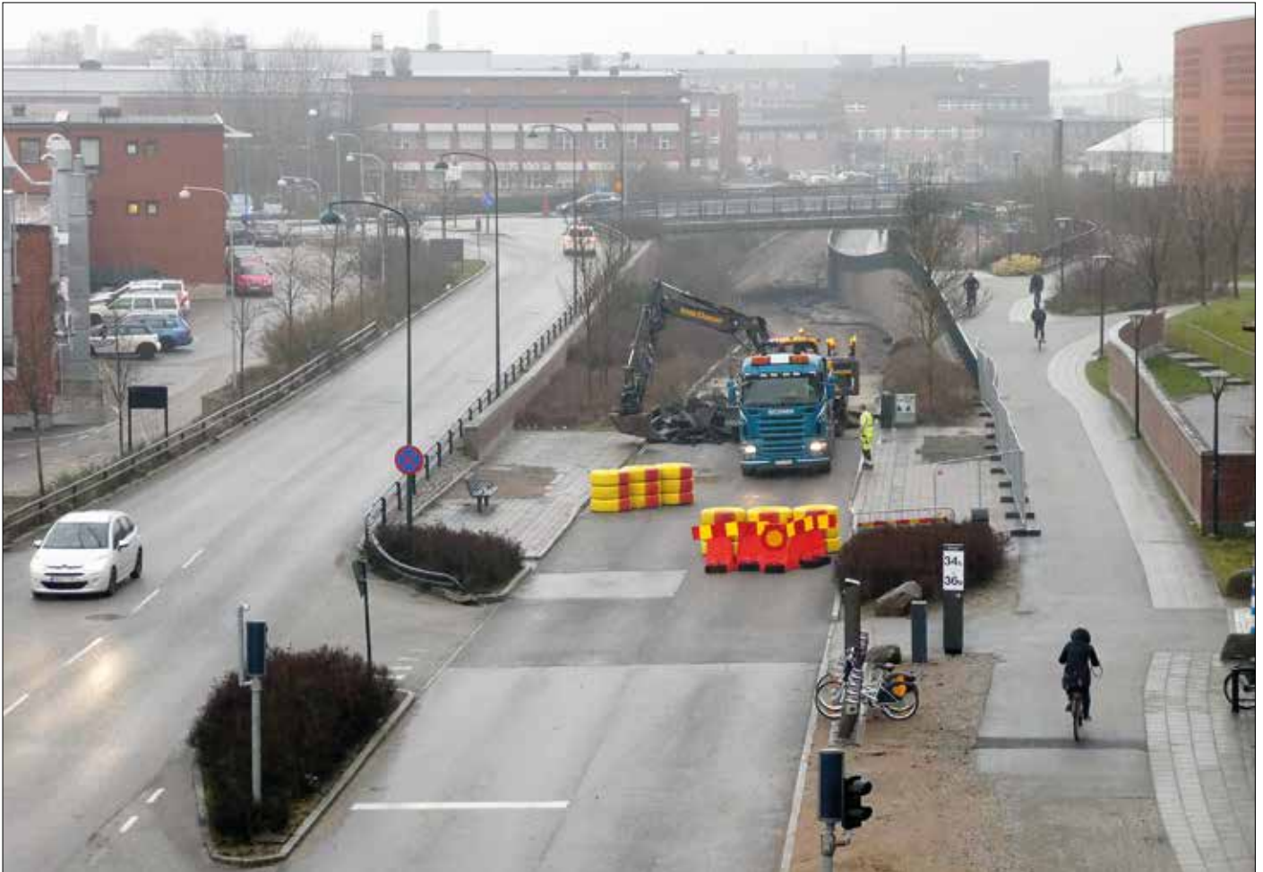
Den 4 april pågår upprivning av körbanan på Lundalänken nära vägporten under Tornavägen som skymtar i bakgrunden.
