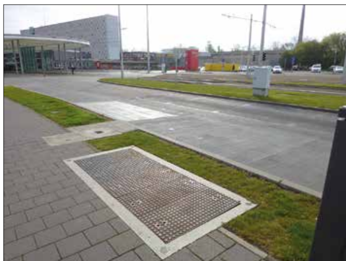
En av de tre laddpunkterna vid Braunschweig Hauptbahnhof. Under gallret finns likriktare med mera för den elektriska matningen. Anläggningen bygger ca 4,8 meter under markytan.
