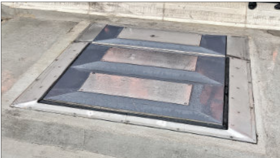
Batteribussarna kan stillastående snabbaddas via dessa markkontakter som utgör den fasta delen av Alstoms statiska laddsystem Static Recharging System , SRS.
