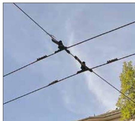
Gammal kontaktledningsmateriel på Zamoskagatan. Trädklämma provisoriskt fastsatt på bärtråden med hjälp av ståltråd. Hela gatan har gammal kontaktledningsmateriel.
