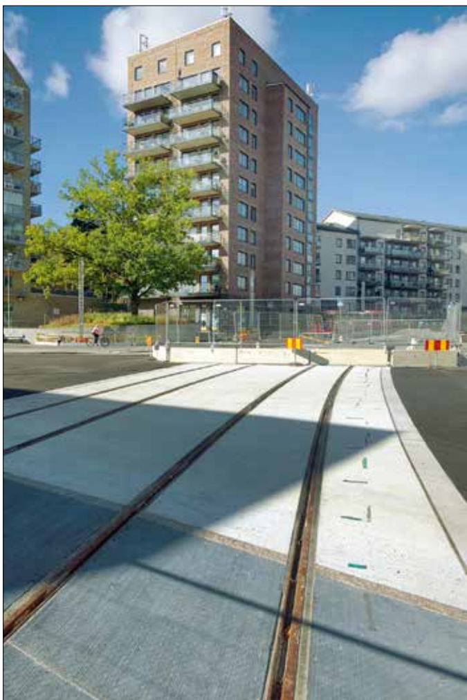
Också i Kavallerivägen, omedelbart intill norra landfästet för Solvallabron, har spår lagts i korsningen med Rissneleden. Estetiskt tilltalande är att också i gatukorsningen finns den så kallade vita linjen som tydligt markerar spårvägens utrymme.
