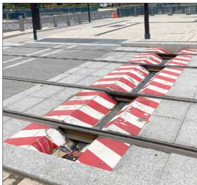
På Porte Maillot har ett hinder byggts så att biltrafik inte kör in på den nya spårvägssträckan. Skrapmärken och andra blessyrer indikerar att det har varit i funktion.
