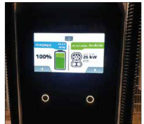
Laddstolpe i depån med informationsdisplay som visar laddningstillstånd respektive tillgänglig laddeffekt.
