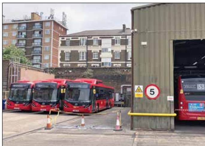
Till höger syns verkstadsbyggnaden som är i måttliga dimensioner. Till vänster finns plats för fyra batteribussar som backas in mot de fyra laddare med hög effekt som finns på depåområdet. Dessa är på 80 kW och ger full laddning på fyra timmar.
