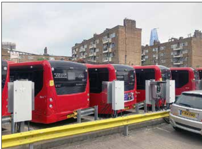
Batteribussar under laddning vid mittrampen mot vilken de backas in. Längs mittrampen har 21 av de 43 laddarna monterats på en yta som fyllts med singel på ett galler för dräneringen.
