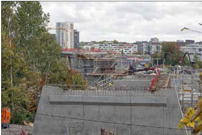
Här ansluter Sollvallbron till marknivån i Rissne. Bakom fotografen korsas Risseleden i plan, med trafiksignaler, innan banan fortsätter uppför Kavallerivägen.
