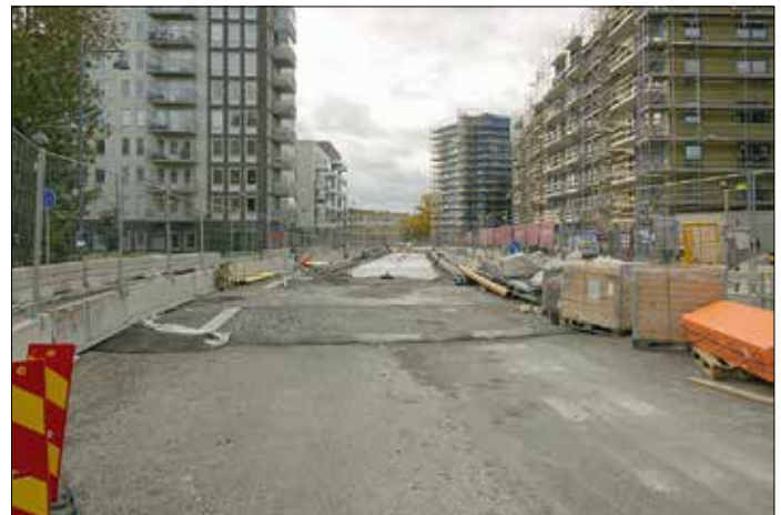
Sträckningen i Kavallerivägen söderut mellan Rissne och Solvällabron: att underlaget utgörs av en helgjuten betongplatta framgår.
