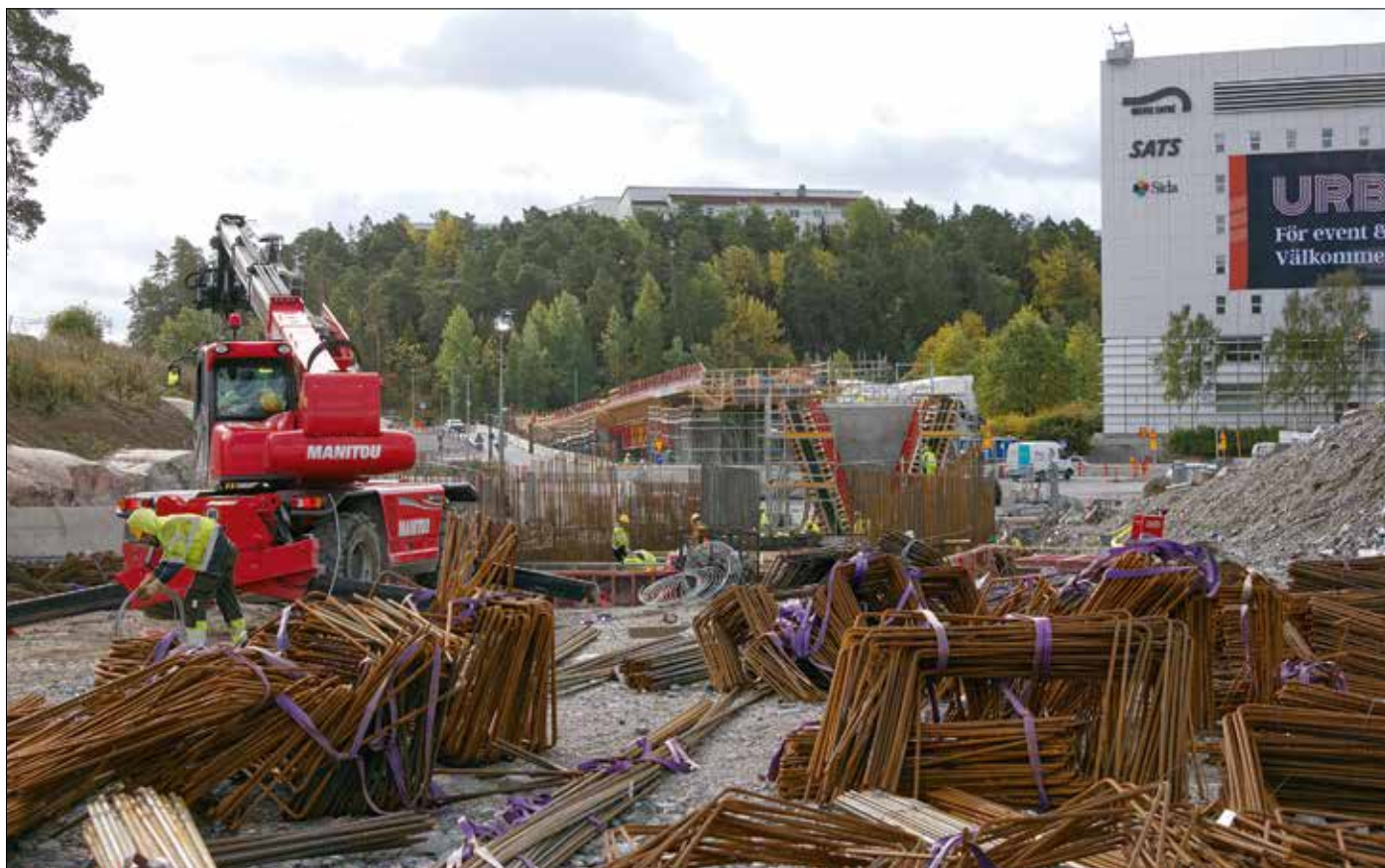
Mellan Rissne och Ursvik ska Kistagrenen passera Enköpingsvägen på en viadukt som nu är under byggnad. Till höger skimtar SEB:s tidigare huvudkontor, Bankhus 90, numera Ursviks entré. Mängden armeringsjärn imponerar.
