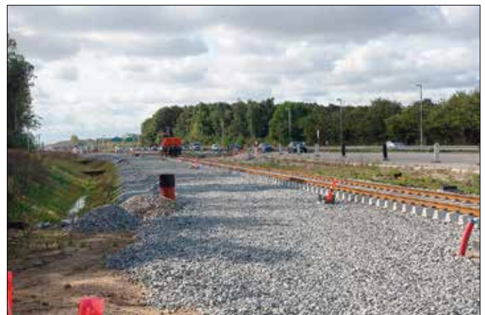
Spårvägsbyggnation utmed motorväg utanför Köpenhamn. Mellan Ishøj och Lyngby kommer letbanen att gå längs motorvägen Ring 3.
