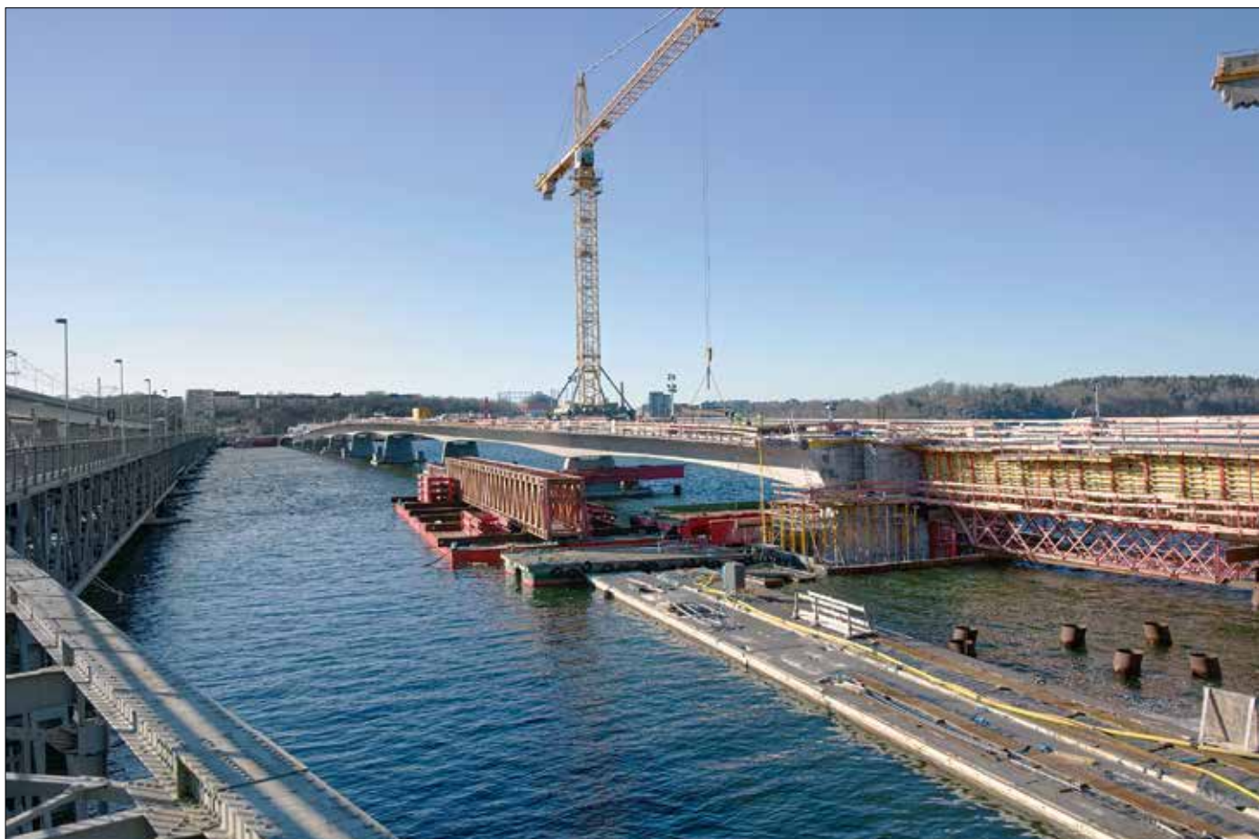
Lilla Lidingöbron under byggnad i slutet av februari 2022. Den raka brodelen är i princip färdiggjuten, liksom gång- och cykelbanornas fortsättning mot Lidingö, bakom ryggen på fotografen. Den böjda brodelen för spåranslutningen mot Lidingö återstår alltjämt. Till vänster gamla Lidingöbron och därbortom stora Lidingöbron.
