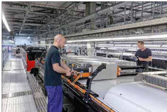
Montering av batterier på busstak.
