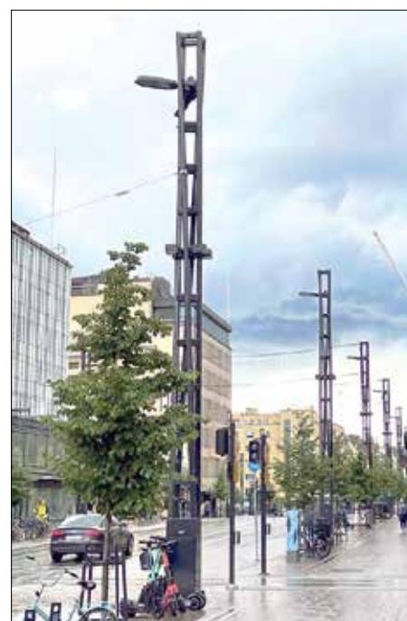
I centrum har kontaktledningsstolpar av en speciellt utformad modell utplacerats.
