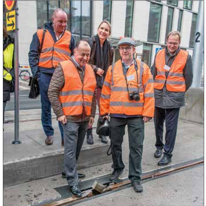
Till höger: Faegh Adel Pour demonstrerar hjulstoppet vid änden av den nya spårvägsförlängningen på Klarabergsgatan. När ett spårvagnshjul kommer för nära reser sig metallklacken, som på bilden, och vagnen hejdas förhoppningsvis.
