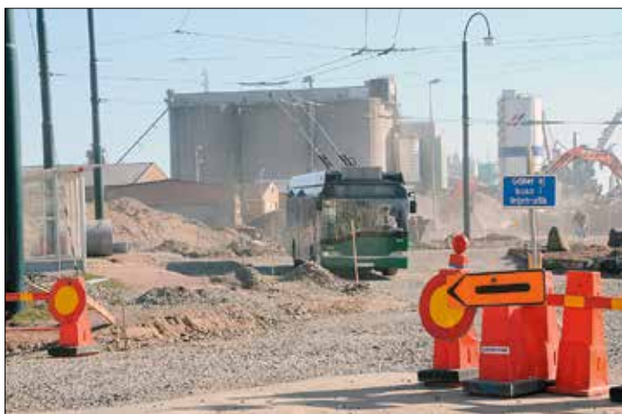
I april 2009 byggs det om vid ändstationen Skeppsbron för att ge plats för ett nytt resecentrum. Trådbussarna rullade under byggtiden så mycket det går genom byggplatsen. På bilden väntar Ella, som nu har nummer 6991, på avgång från Skeppsbron.
