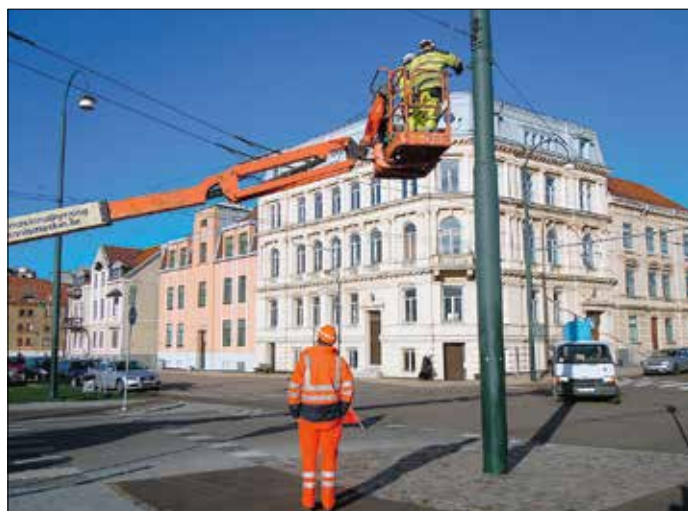
Ombyggnaden av Skeppsbron för det nya resecentret innebar att kontaktledningen inte satt optimalt för den nya gatuutformningen. Under trafikstoppet hösten 2010 justerades kontaktledningen i syfte att alla hållplatslägen skulle kunna användas utan hinder för trådbussarna. På bilden från den 8 november 2010 ser vi arbetslaget jobba med kontaktledningen.
