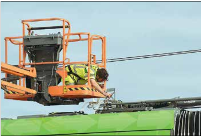
Från en sky-lift, hyrd från Skanskas arbetsplats på ESS, lossas transportsäkringarna för strömvagnen.
