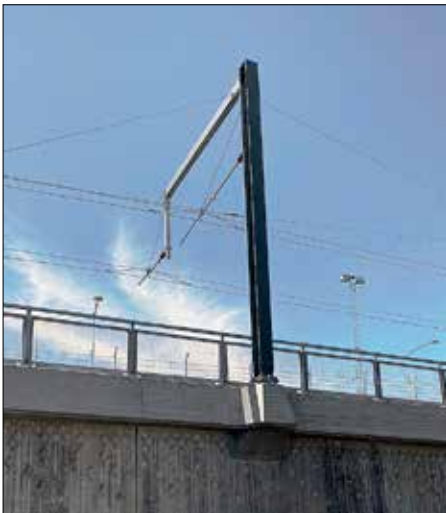
Specialkonstruktion för kontaktledningen nära Bromma flygplats: Stolpe i H-profil med kraftig horisontell utliggare för spåret längst bort från stolpen. Foto: Martin Lindahl
