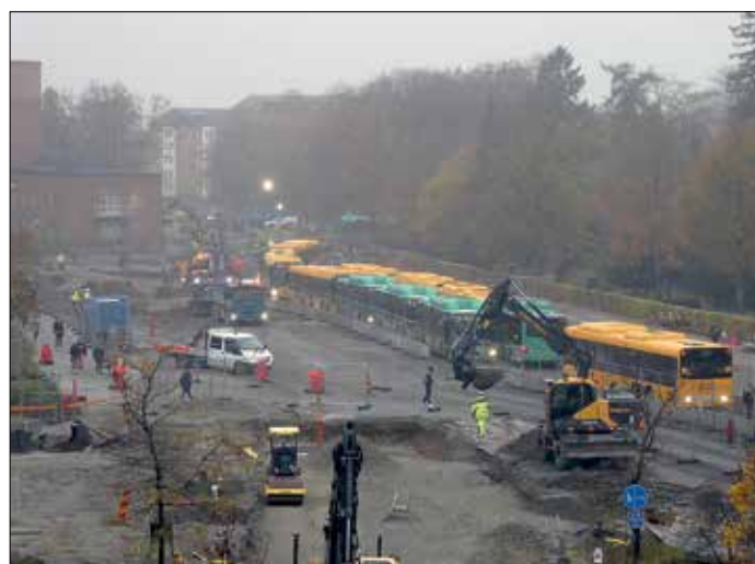
I Lund har perioden 2016 till 2019 präglats av spårvägsbygget som i november 2018 kulminerade i totalt kaos vid Universitetssjukhuset där bussarna fick köra i "enkelspår".
