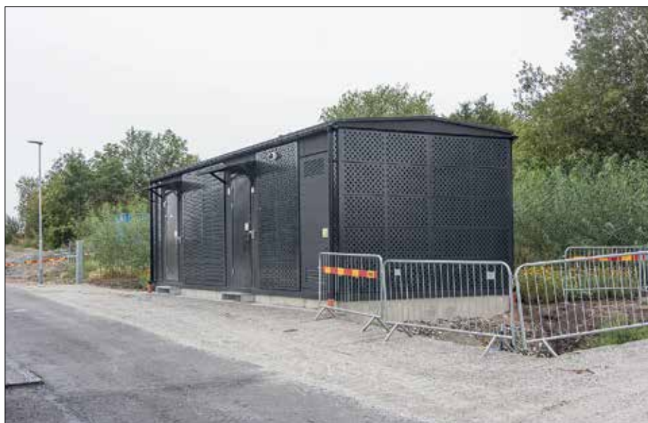
Likriktarstationen vid hållplats MAX IV, en av fem stationer som finns utmed spårvägen i Lund. En sjätte station finns i depån.
