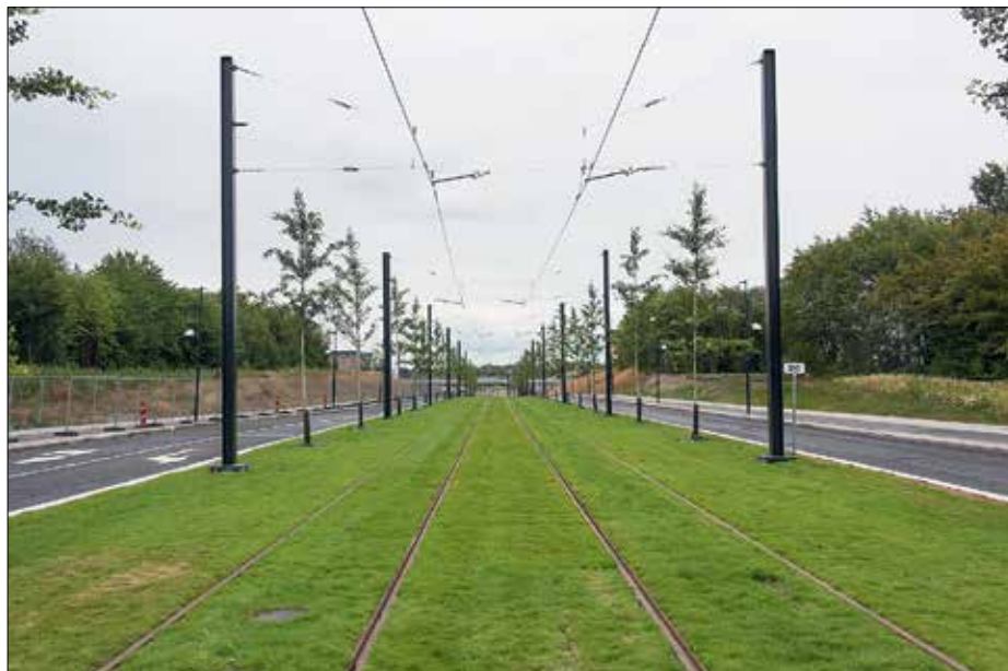
Spårvägens kontaktledning monteras på 5,5 meters höjd. Kontakttråden har arean 107 kvadratmillimeter. Här är ledningen upphängd i linspann från sidoplacerade stolpar.
