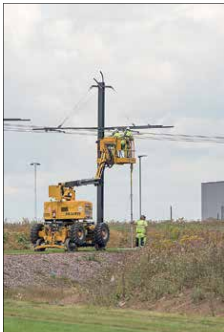
Kontaktledningsjustering nära ESS.
