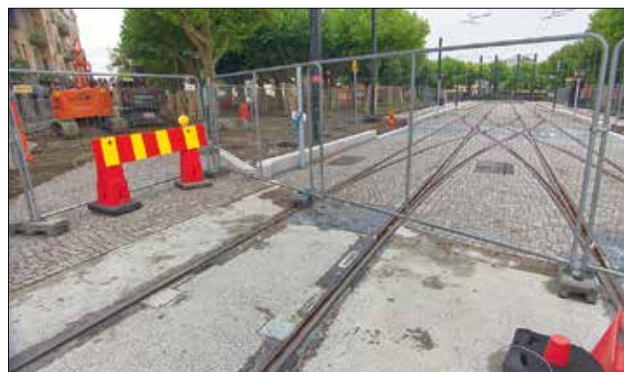
Det är ont om utrymme vid ändhållplatsen vid Clemensstorget. Kryssväxelns tungor tangerar på centimetern korsande körbanan i torgets norra ände. Förhoppningsvis riskeras inga växelstörningar.
