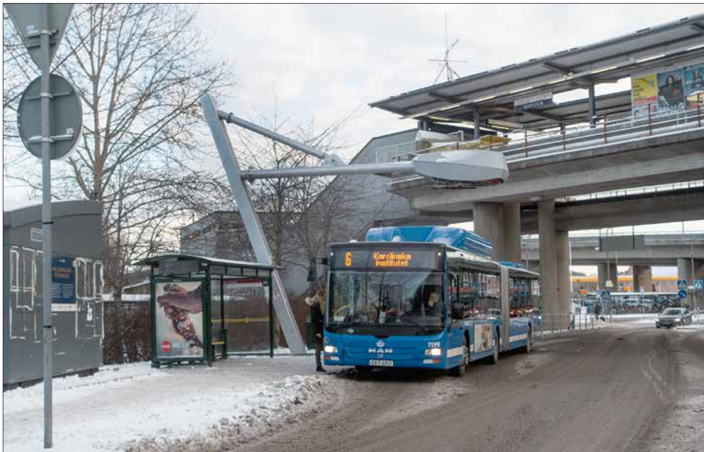
Nej, det går inte att ladda en gasbuss! Ändhållplatsen för tidigare linje 73 i Ropsten övertogs runt årsskiftet 2017–2018 av nya stombusslinje 6, men laddanordning och teknikhus (till vänster) från det tidigare laddhybridbussprojektet står kvar.
