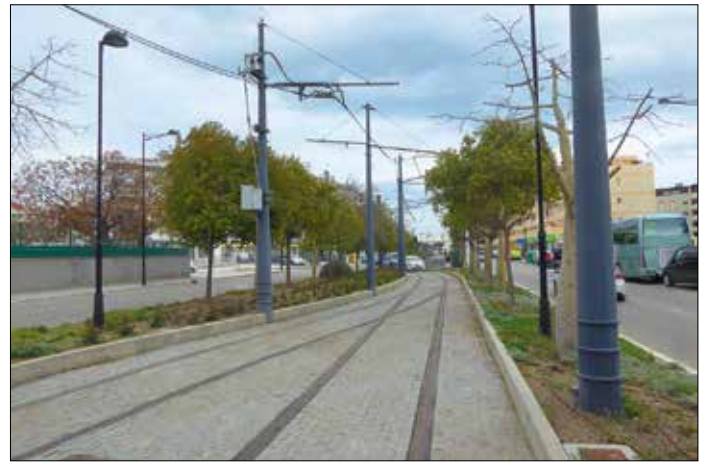
Kontaktledningen i centrum är nedtagen på vissa sträckor. Ej spänningssatt kontaktledning blir inte sällan stulen.
