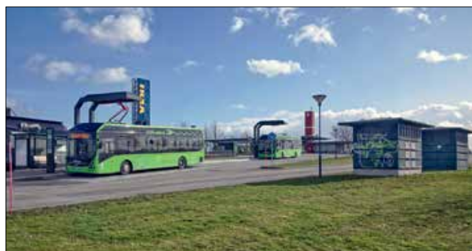
Vid ändhållplatsen Svågertorp på den 14,88 km långa batteribusslinjen 7 i Malmö finns två laddningsstolpar, med pantografer som sänks ned mot busstaket. Vid den andra ändhållplatsen, Ön, finns en ensam laddningsstolpe.
