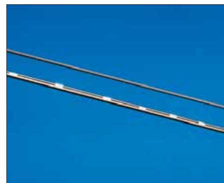
Kontaktledning med värmekabel monterad ovanpå körtråden; bärlina strax ovanför.
