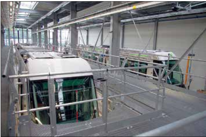
I verkstaden finns plattformar för arbete på fordonens tak, fordonslyftar och arbetsgravar.
