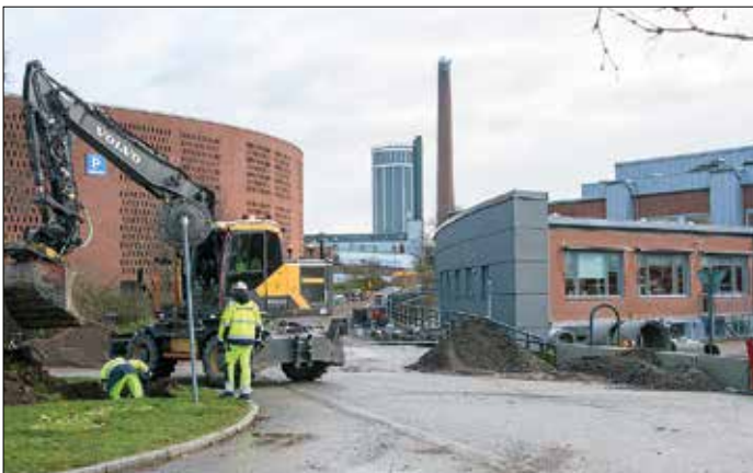
Bussbanan Lundalänken är här invid Skånes universitetssjukhus, SUS, tydligt naggad i kanten. I framtiden ska spårvagnar trafikera rampen mellan parkeringshuset till vänster och köksbyggnaden till höger.
