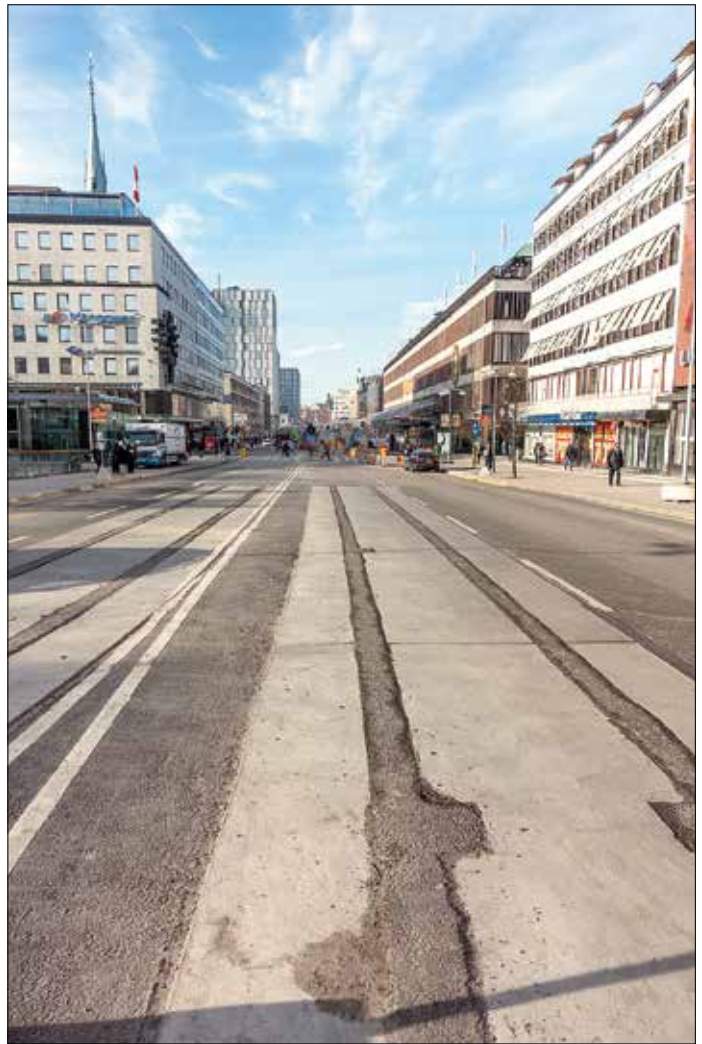
Spår av kommande spårväg på Klarabergsgatan, med urtag i betongen för avvattnings- eller jordläda närmast till höger, den 10 mars 2016.
