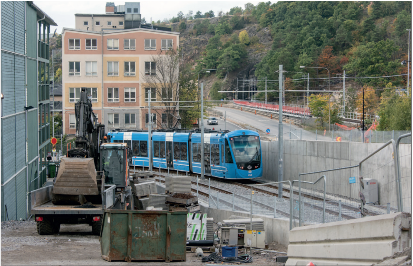
Nya sträckan mot Sickla går i ett betongtråg intill Värmdövägen som syns till höger, där även Saltsjöbanan kan anas, med tunnelmynning i Henriksdalsberget. Till vänster strax bortom kurvan börjar grässpåret på Uddvägen.
