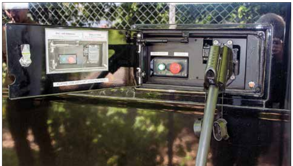
Anslutning av laddkabel sker på bussens högra långsida. Här långsamladdas med en effekt av 50 kW under nattuppehåll. Vid snabbaddning vid ändhållplatserna via laddmast och takströmavtagare (laddarm) kan effekten uppgå till 240 kW.
