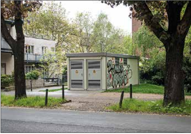
Vid ändhållplatsen Zollstock Südfriedhof har denna teknikbyggnad uppförts. Den innehåller utrustning för de två laddmasterna. Vid centralstationen finns också en teknikbyggnad, dock i mindre storlek.
