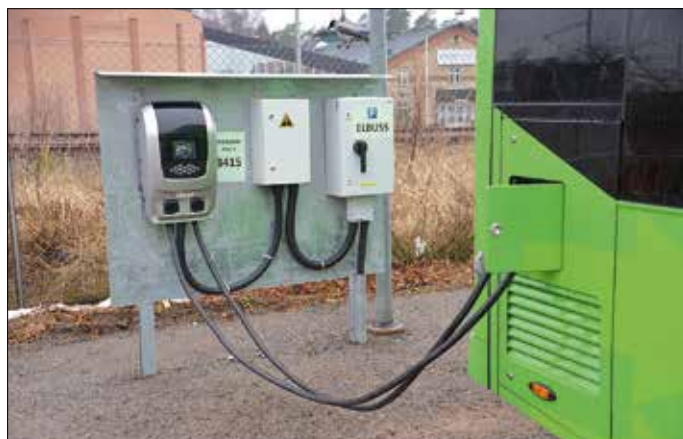
Laddpunkt på depån. Två kablar med 400V växelspänning kopplas till bussen.
