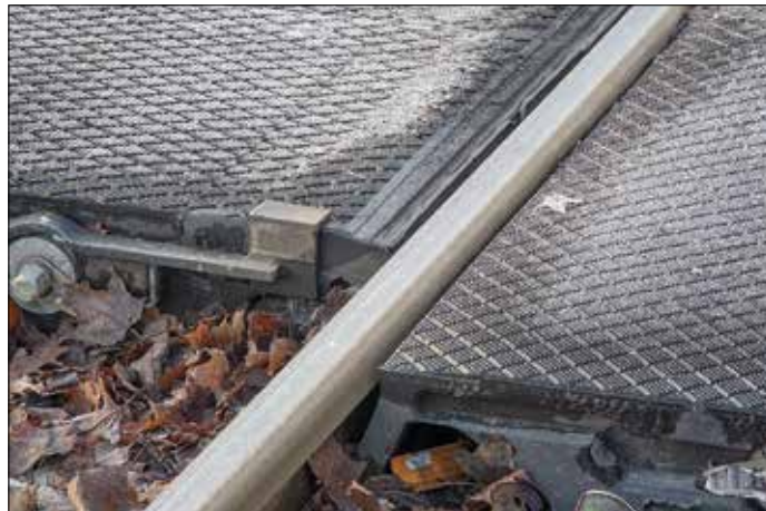
Velostrail har en gummiutfyllnad i spårets ränna så att också cyklister riskfritt kan passera övergången. När spårvagn passerar trycks gummilisten ned av hjulflänsarna, och återtar ursprungligt läge efter passage.
