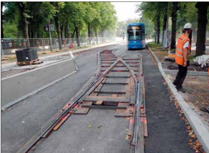
För att på Tvärbanan kunna vända tåg vid den provisoriska ändhållplatsen i Hammarby sjöstad övervägs att använda de klättrväxlar som under hösten 2014 utnyttjades i samband med ombyggnaden av hållplats Nordiska museet på Spårväg city.
