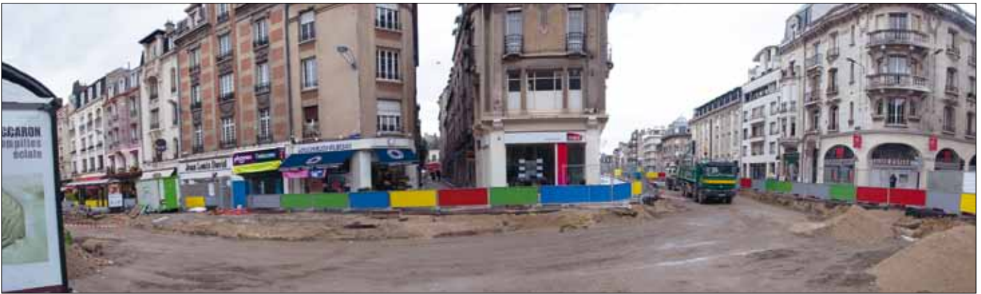
Den uppgrävda staden: Gathörnet Cours Jean-Baptiste Langlet (th) och Place Myron Herrick är ganska stökigt på denna bild från den 15 maj 2009. Marken under den blivande spårvägen är förberedd så att ett första lager betong snart kan gutas. Strax därefter kommer spåren att läggas ut och återbyggnad av gatans struktur att inledas. Fransk spårvägstradition innebär komplett upprustning av gaturummet, från fasad till fasad.
