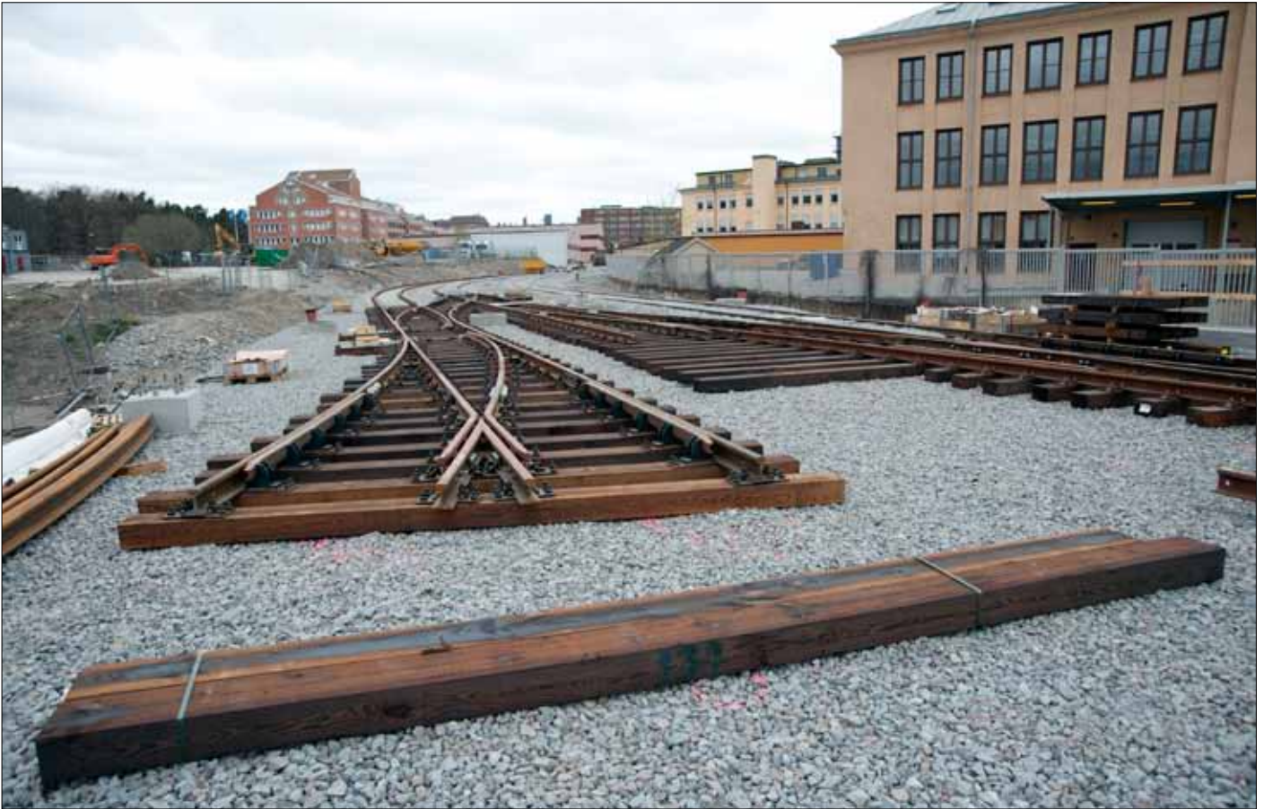
I slutet av april skedde i Johannesfred första spårläggning för Tvärbana Norr Solnagrenen, på sträckan som passerar intill den blivande depån i Ulvsunda.
